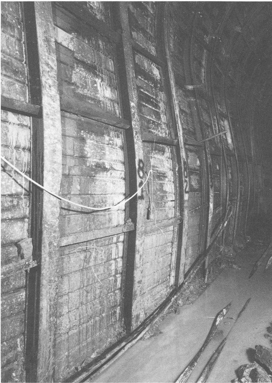
Fig. 7. — Effets de la poussée des terrains sur les soutènements en acier. Les déformations atteignirent par endroits 40 à 50 cm.
