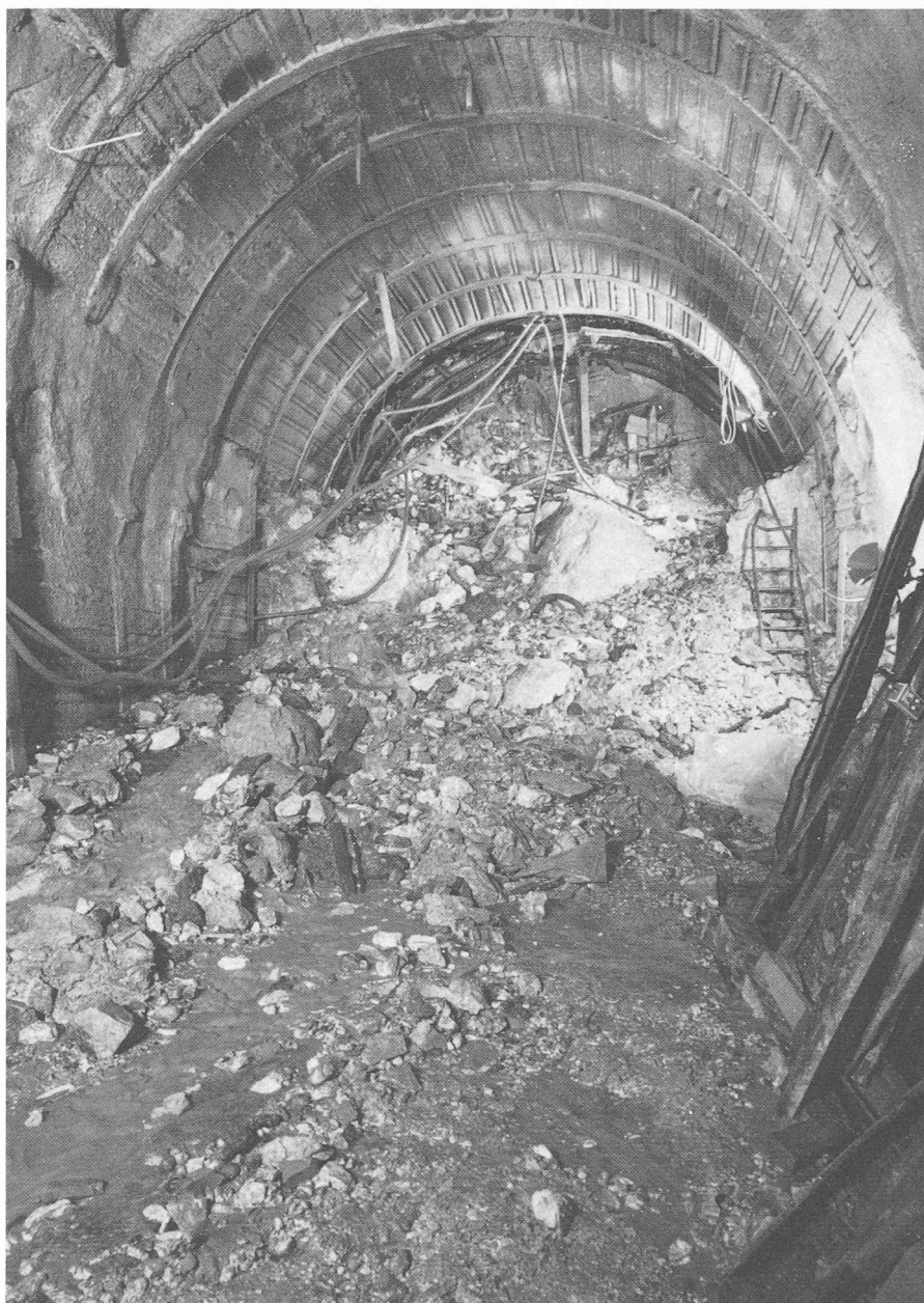
Fig. 6. — km 3,380: entrées d'eau, de boue et de roches dans la zone du granite de Rotondo (29 juin 1977). L'avancement en a été retardé de six mois.
