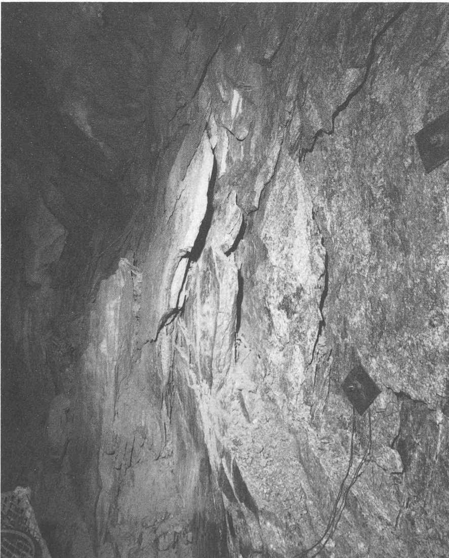
Fig. 5. — km 7,518: détachements de pierres typiques, pareils à des éboulements, dans le granite de Rotondo sous une couverture d'environ 1350 m.
