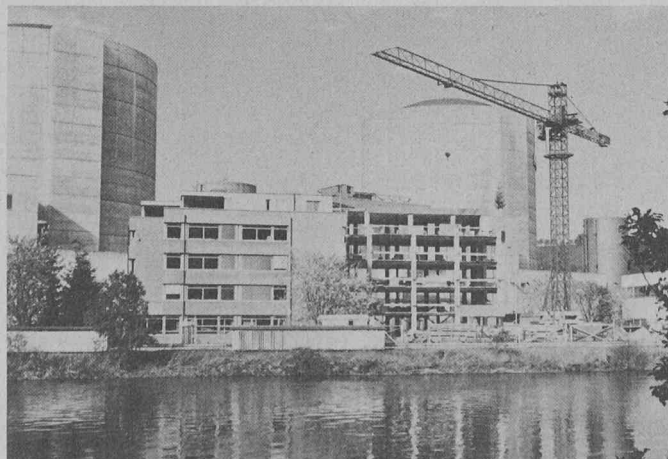
Bâtiment d'accès de la centrale nucléaire de Beznau I et II. A gauche le bâtiment administratif, à droite gros œuvre du bâtiment d'accès.
