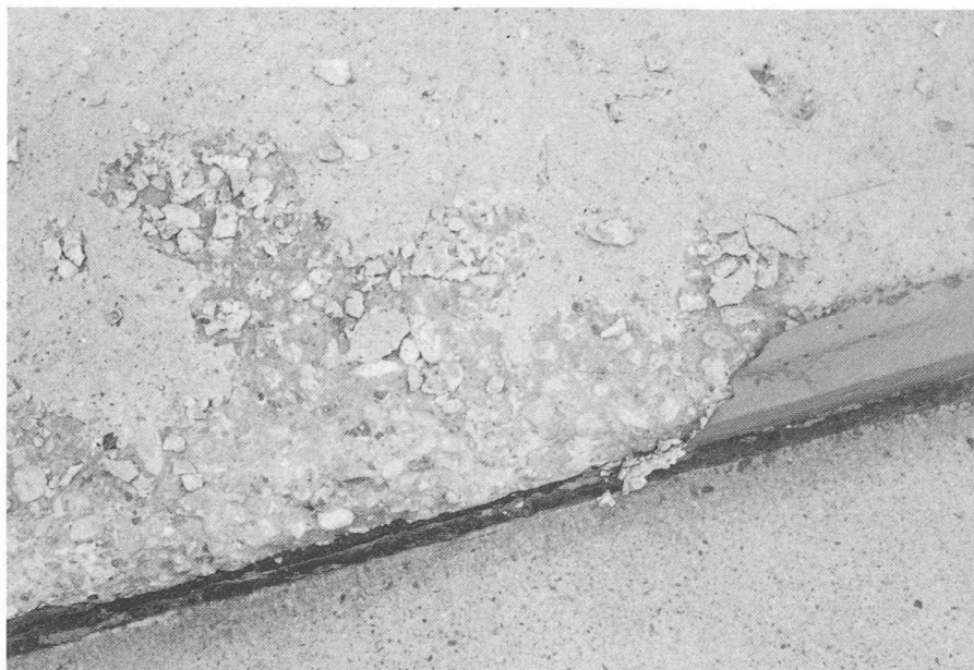
Fig. 4. — Béton désagrégé par le choc de température provenant du sel de déneigement. On remarque très bien la différence entre le béton de la surface et celui du noyau. Une protection ne peut pas empêcher cette désagrégation.
