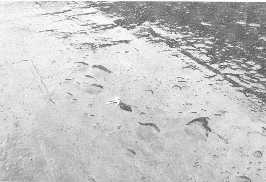
Fig. 3. — Bulles apparues sous une feuille préfabriquée à base de bitume modifié.
