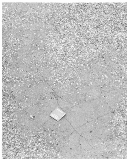
Fig. 6. — Ce revêtement d'asphalte coulé s'est désagrégé après un hiver seulement, l'étanchéité étant épaisse et trop tendre.
