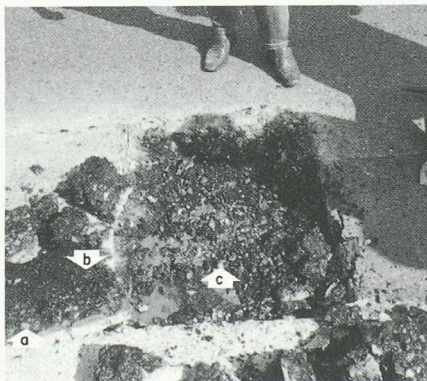
Fig. B3. — Echantillon 1: le revêtement en enrobé, d'une épaisseur totale de 11 cm, a sa couche inférieure désenrobée (a). Sur les faces de rupture, le bitume se détache du gravillon (b). L'étanchéité est recouverte de gravillon désenrobé et d'eau stagnante provenant du revêtement (c).
