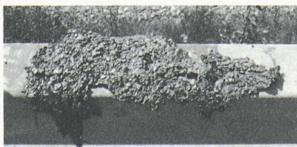
Fig. B5. — L'étanchéité qui a été enlevée, avec le béton qui y adhère (à l'envers).
