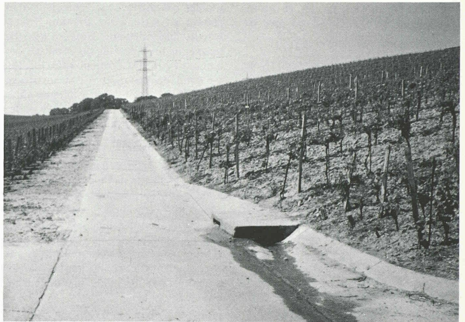
Fig. 2. — Chemin bétonné prévu pour l'interception de l'eau de ruissellement.
