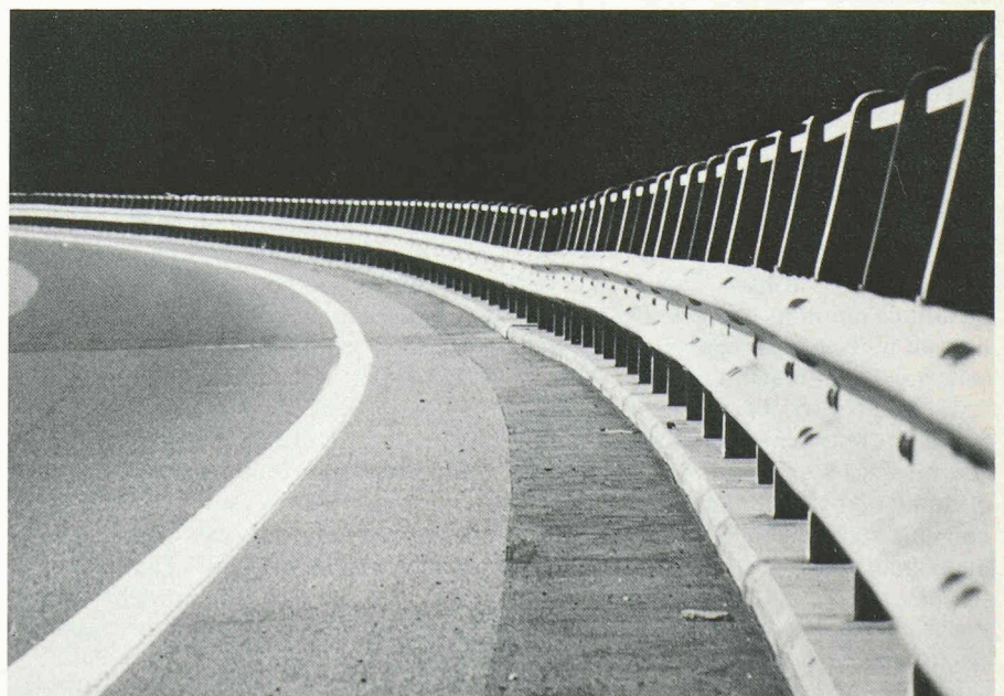
Fig. 2. — Les déformations apparaissant progressivement avec le temps peuvent devenir trop importantes et désagréables pour les usagers et également provoquer des frais d'entretien élevés, notamment dans les joints de tabliers des ponts (photo B. F. Gardel).
