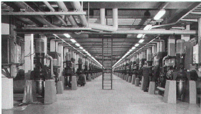
Installation d'épuration Lynetten, Copenhague, 115 pompes TURO.
