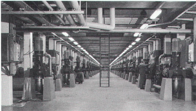
Installation d'épuration Lynetten, Copenhague, 115 pompes TURO.
