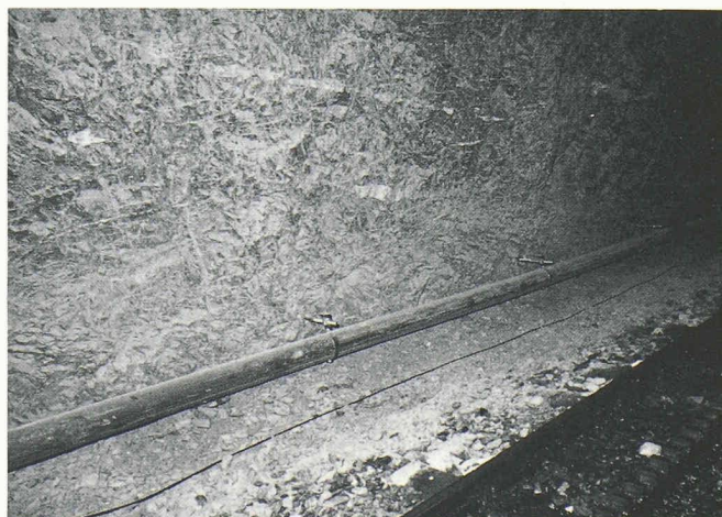
Fig. 5. — Cette conduite suspendue dans le tunnel du chemin de fer sert à conduire les eaux usées du restaurant à la STEP de Grindelwald.
