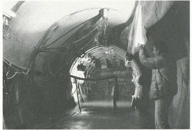
Fig. 6. — L'eau monte dans la galerie. PK 405. (Photo Fiala.)
