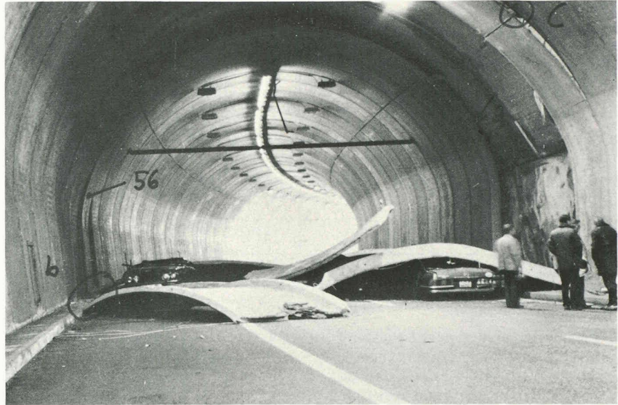
Fig. 4. — Perte de stabilité d'un revêtement rapporté en béton armé préfabriqué après l'impact d'une voiture. Il n'y a heureusement que des blessés légers. A la suite de cet accident, des mesures ont été prises pour prévenir de tels accidents dans les tunnels de routes nationales.
