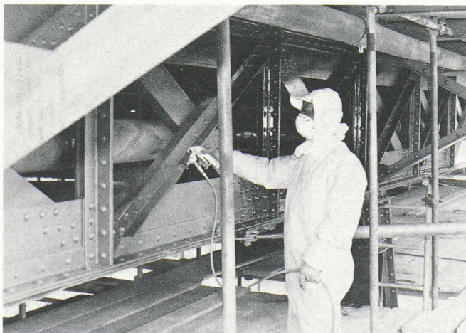
Fig. 8. — Couche de fond de protection contre la corrosion: minimum de plomb avec liant caoutchouc chloré.
