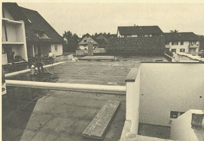
Le toit plat du Centre communal de Nürensdorf (ZH) en cours d'exécution : surface partielle étanchée avec le Sarnafil sur la barrière de vapeur collée en plein et déjà séparée par secteurs (arrière-plan); surface préparée avec des joints de séparation, qui sera séchée après les chutes de pluie (premier plan).
