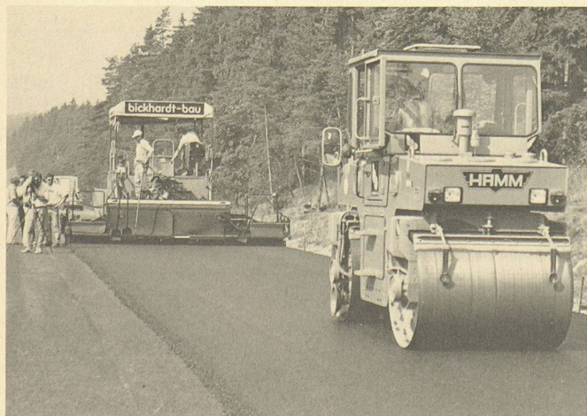
Application du mélange d'asphalte sur le tronçon d'essai de l'autoroute A5. (Photo: Degussa AG.)
