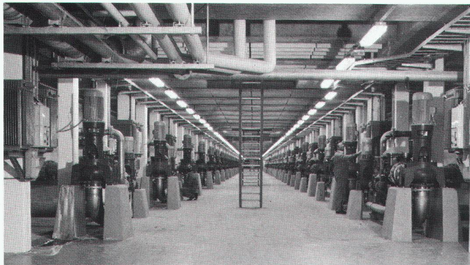
Installation d'épuration Lynetten, Copenhague, 115 pompes TURO.
