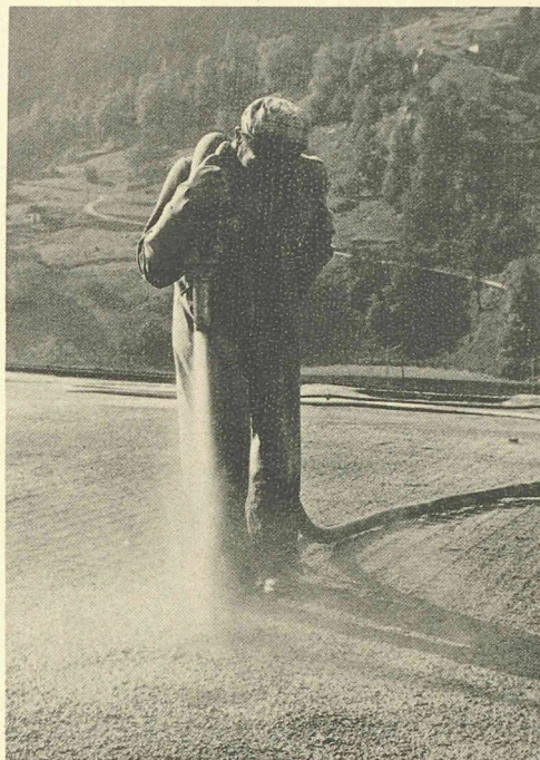
Application de béton projeté sur un ouvrage de protection contre les avalanches.
