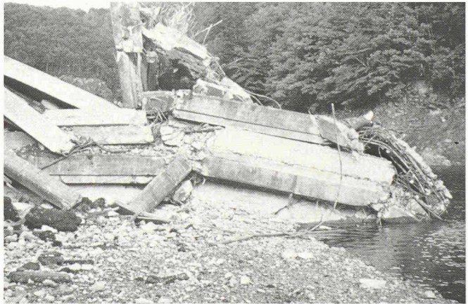
Fig. 5. – Le même pont d'Arpiat, en septembre 1982 : l'ouvrage était condamné, le maître d'ouvrage n'a pas eu la patience d'attendre qu'il tombe tout seul.
