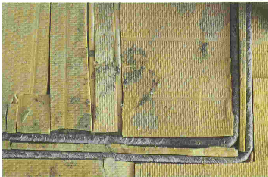
Fig. 3. – Isolation mal posée, ponts phoniques dus aux tuyaux qui coupent l'isolation.
