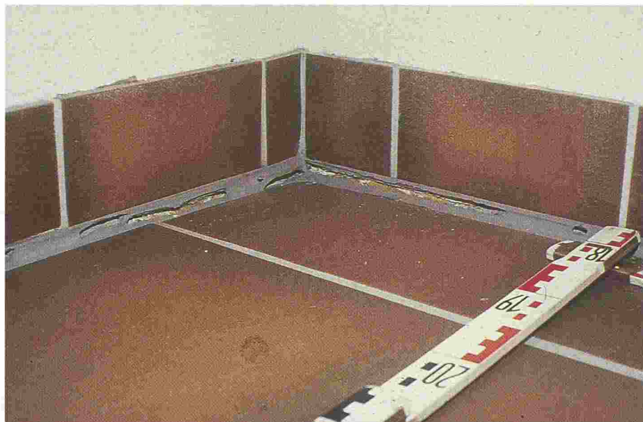
Fig. 2. – Contre-déformations, affaissement sur les bords et rupture du joint mastic.
