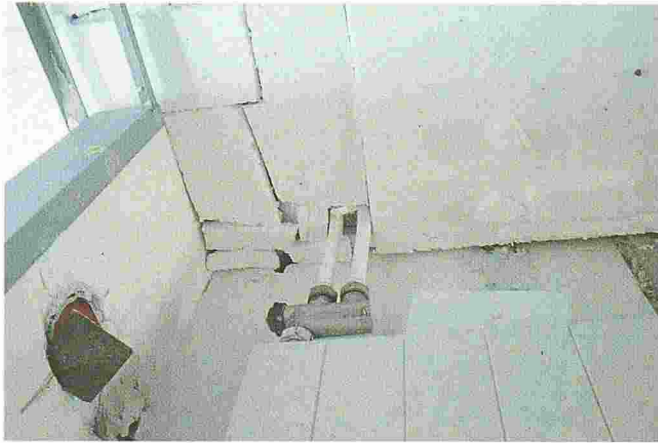
Fig. 4. – Isolation mal posée, les multiples morceaux provoquent des ponts phoniques.
