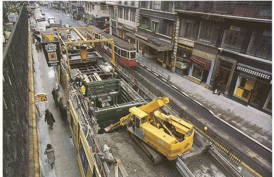
Fig. 6. - Organisation «compacte» du chantier: travaux d'excavation suivis du bouclier, du dispositif de bétonnage et de la fermeture de la fouille. Le trafic est maintenu sur les deux trottoirs et sur une partie de la chaussée avec une voie provisoire du tram.
