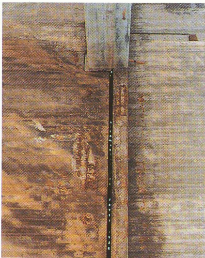
Fig. 2. - Vue du joint de dilatation.
