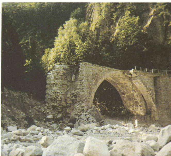
Fig. 8. - Le pont sur la Meienreuss le 25 août 1987, en aval, effondrement de l'élargissement de 1949, voûte de béton détruite jusqu'au-dessus de la clé. (Photo: R. Kalbermatten.)
