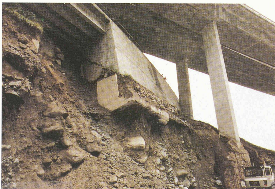
Fig. 7. – Vue d'en dessous de la fondation affouillée et dégagée du mur de soutènement et de la culée du viaduc de la route cantonale. (Photo: T. R. Schneider, 1878/12, 1878/19.)
