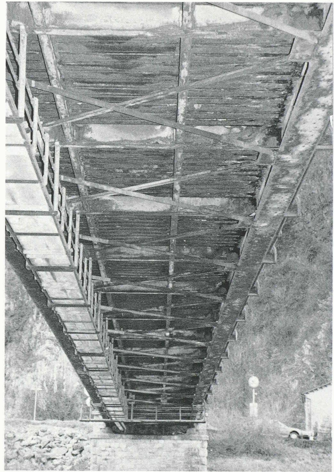
Fig. 6. - Dessous du pont rouillé.
