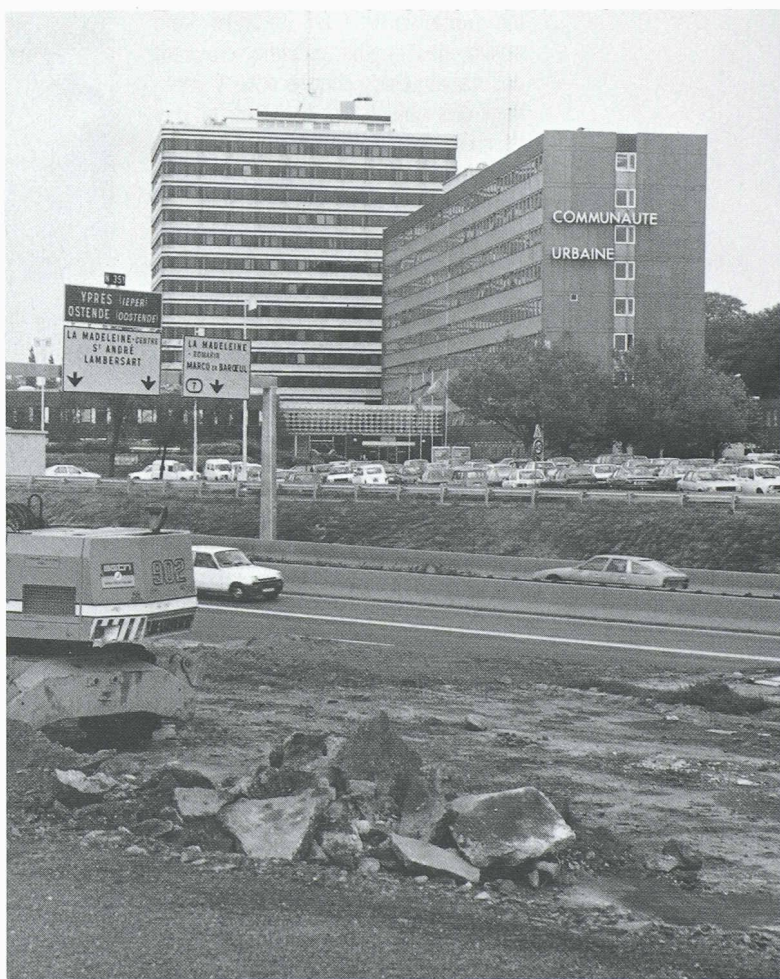
Fig. 9. — Hôtel de la Communauté urbaine, le nouveau tracé du périphérique et les premières marques du chantier TGV.
