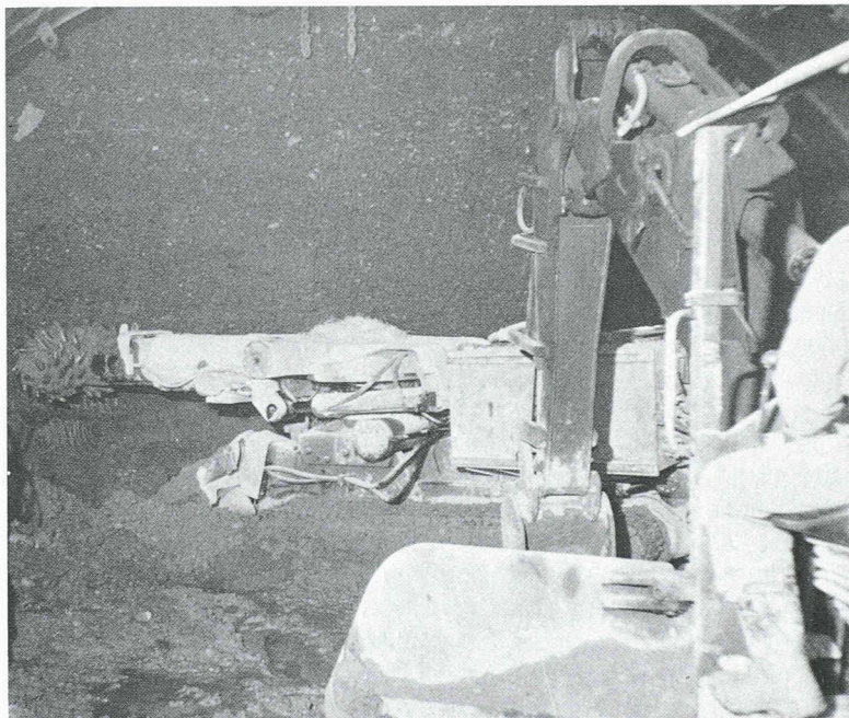
Fig. 3. – Avancement en calotte du côté Canada, attente de la pelle hydraulique pendant l'abattage à la machine à attaque ponctuelle
