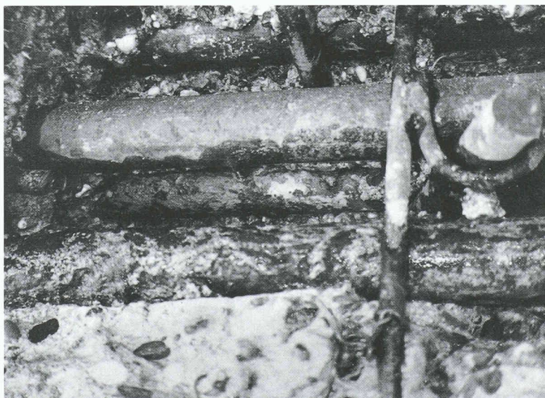
Fig. 4. – Piqûres de corrosion sur barres de gros diamètre
