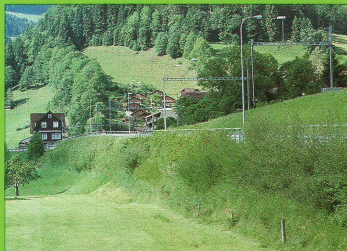
CH-Brunnadern, 1987; H = 6,0 m, L = 170 m; Ouvrage de soutènement pour l'élargissement de la chaussée
