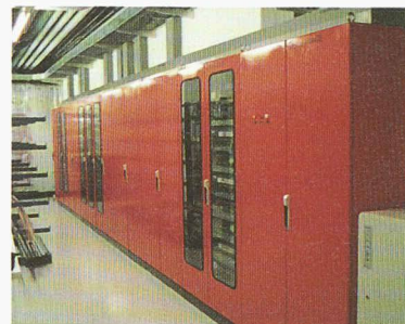
Les armoires de contrôle des installations techniques dans une des centrales (photo Betelec)
