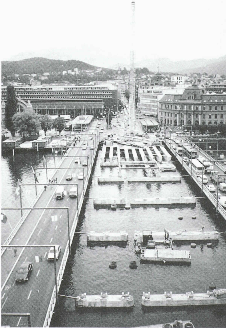
Fig. 6. - Pendant la démolition de l'ancien et la construction du nouveau pont, le trafic est assuré par deux ouvrages provisoires.
