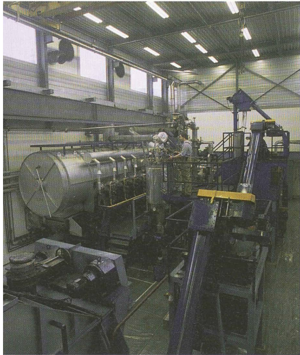
our à pyrolyse pour le traitement des piles usées chez Recymet SA. Le procédé à faible température (650°C) est utilisée pour séparer les oxydes métalliques et les métaux des matières non désirées (mercure, plastiques, etc.). La pyrolyse à 650°C évite des investissements comparables à ceux des fours de fusion. Le minerai produit s'intègre ensuite dans la chaîne de revalorisation du zinc des aciéries européennes (photo Poite).
