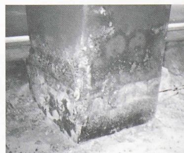
Fig. 5.- Etat du pied d'une colonne centrale avant la remise en état
