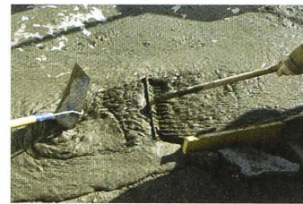
Le BEUP, à la fois autocompactant et vibropropre, est travaillé avec des outils standards (Photo A. Herzog)
