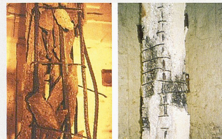
Réduction de l'écaillage par le resserrement des étriers bien ancrés (Photo Walter Borgogno)
