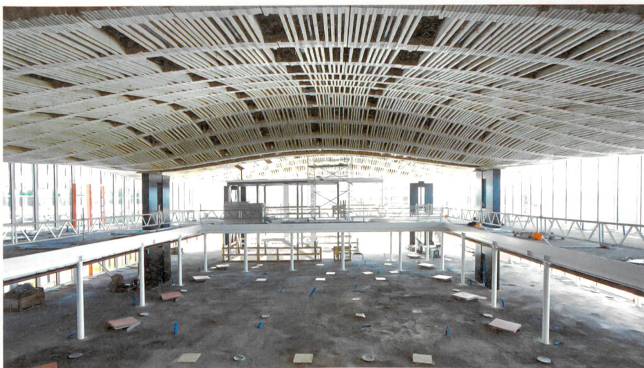
Vue du Arch_Tec_Lab, basé sur le BIM, à l'Institut pour la technologie en architecture (ITA) de l'EPFZ. (Photo arch_tec_lab AG/ Andrea Diglies)
