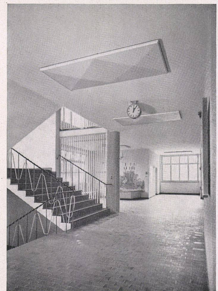
Abb. 3 Treppenhaus mit Decken- Strahlungsheizung
