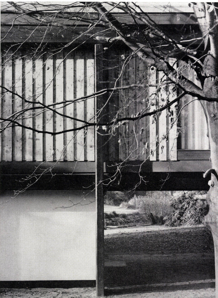
Detail der Ostwand mit Holzfüllelementen. Détail de la paroi est avec éléments de remplissage en bois. Detail of east partition with wood panel elements.
