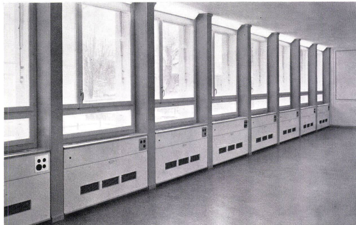
Büroraum mit eingebauten Sulzer-Klimakonvektoren
