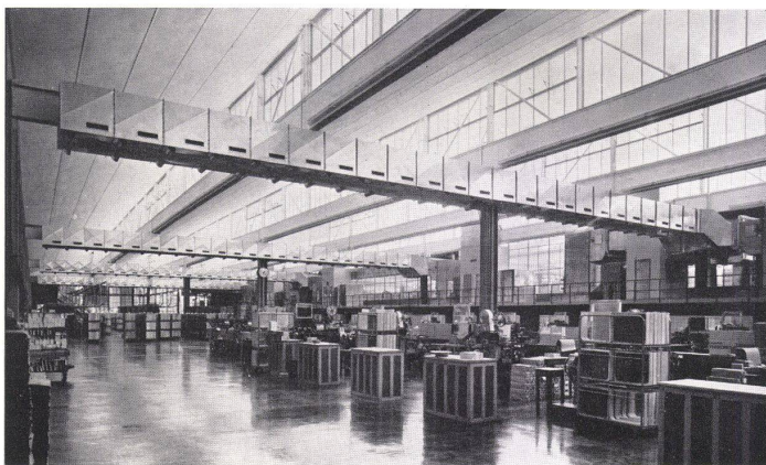
Klimaanlage in einer Tabakfabrik
