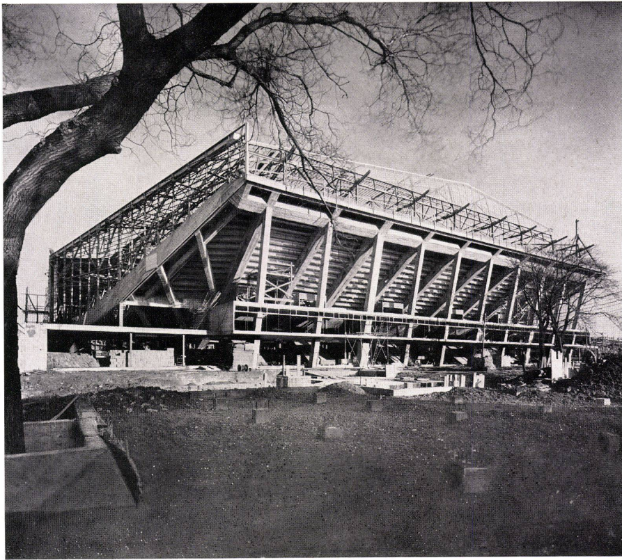
1 Haupthalle von Südwesten mit Untersicht der Südtribüne. Halle principale du sud-ouest et vue de sous la tribune sud. Main arena from south-west with view under the south gallery.
