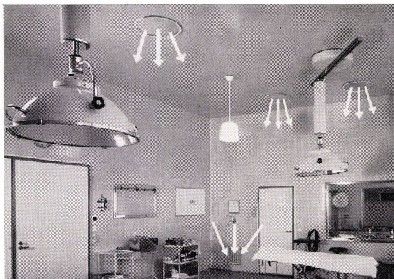
Klimaanlagen in Operationsräumen —
