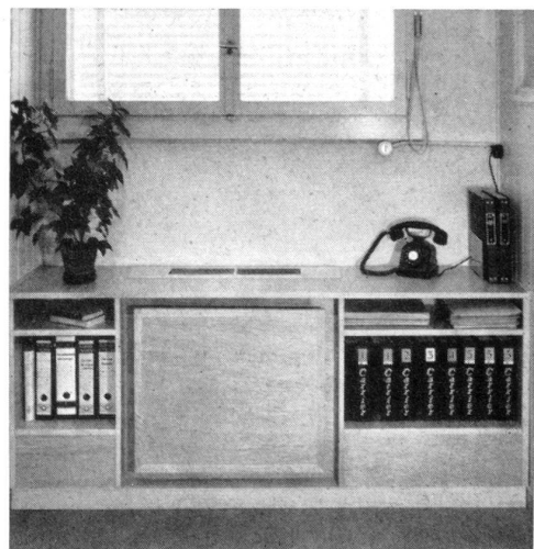
Konvektor in Fensternische verschalt
