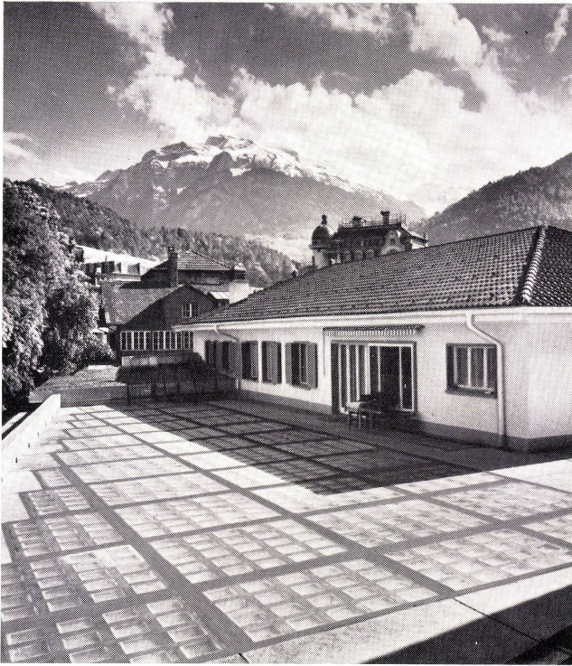
Auf diesem Flachdach eines Restaurants im Berner Oberland wurden die Fugen mit GOMASTIT ausgegossen und damit absolut wasserdicht gemacht.
