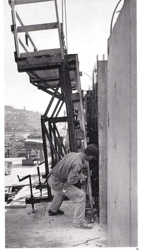
3 Einfügen des 2. Wandschalungselementes. Pose du 2ème élément de coffrage du mur. Positioning of the 2nd wall coffering element.
