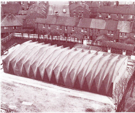
8 Aufbau eines räumlichen Tragwerkes mit belasteten Flächen in Texas / Construction d'un appareil porteur spatial aux surfaces chargées, à Texas / Construction of a spatial supporting frame with loaded surfaces, in Texas
