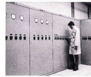
Steuerschränke für Sanitär- und Lüftungsanlagen im Hotel Zürich
