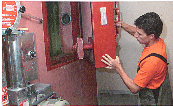
Im Zentrum steht die Werterhaltung der bestehenden Infrastruktur.
