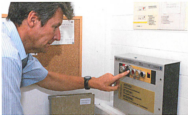
In der Schweiz gibt es rund 4600 stationäre Sirenen, mit denen der Allgemeine Alarm ausgelöst werden kann – in vielen Kantonen auch von zentralen Kommandostellen aus.
