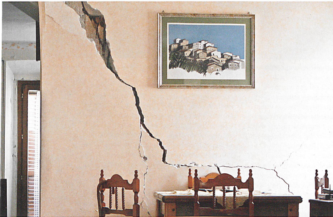
Nach einem Erdbeben muss genau beurteilt werden, ob ein Gebäude noch bewohnbar ist.
