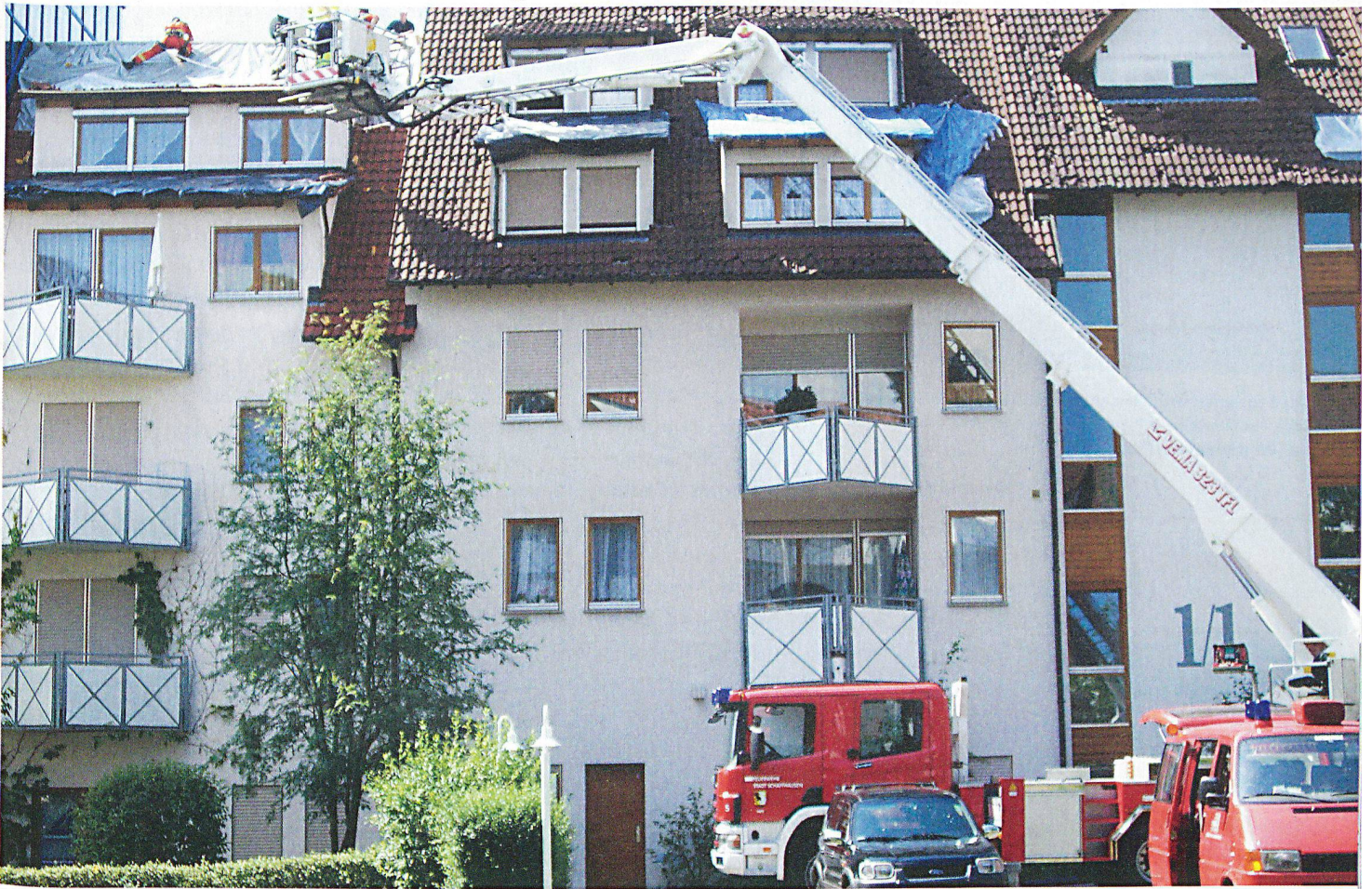
Am 28. Juni 2006 zog ein Hagelunwetter über Villingen-Schwenningen und beschädigte tausende Hausdächer. Die Feuerwehr Schaffhausen war vier Tage lang mit dem Hubretter im Einsatz, um gemeinsam mit den deutschen Kollegen Dächer mit Notplanen zu versehen.
