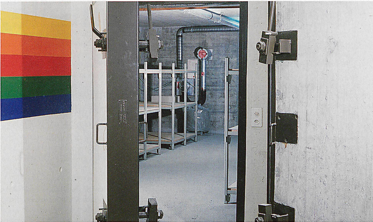
Landesweit gibt es heute etwa 8,6 Millionen Schutzplätze. In rund 900 Gemeinden besteht jedoch weiterhin ein Schutzplatzdefizit.
