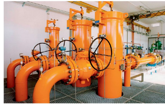
Als einer der ersten Netzbetreiber übermittelt Swissgas Störungsmeldungen mit NetAlert an die Nationale Alarmzentrale NAZ. Im Bild die Zollmessstation Zuzgen.
